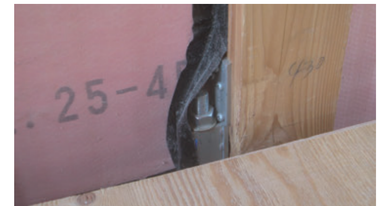
一般的な接合金物による断熱材の欠損
