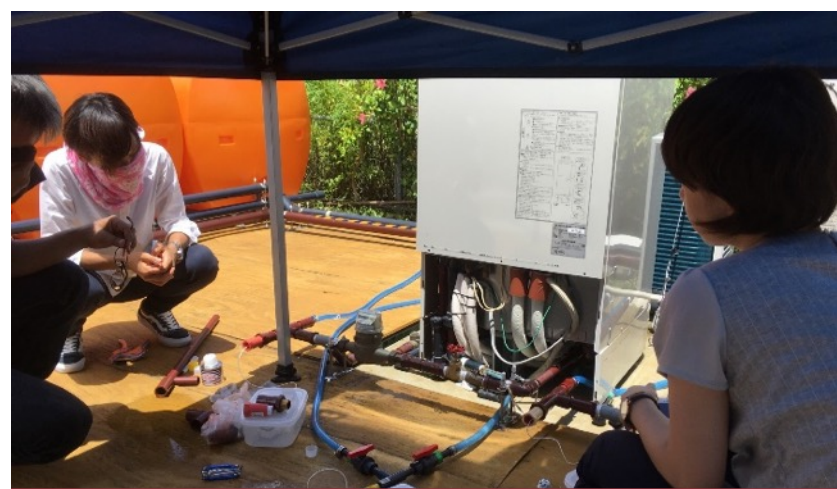
給湯システム実証試験 宮古島にて
